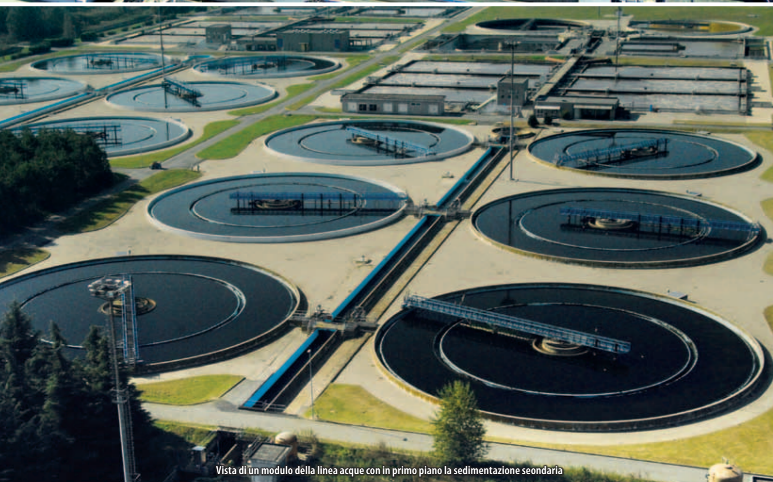
Vista con in primo piano la dissabbiatura e disoleatura
